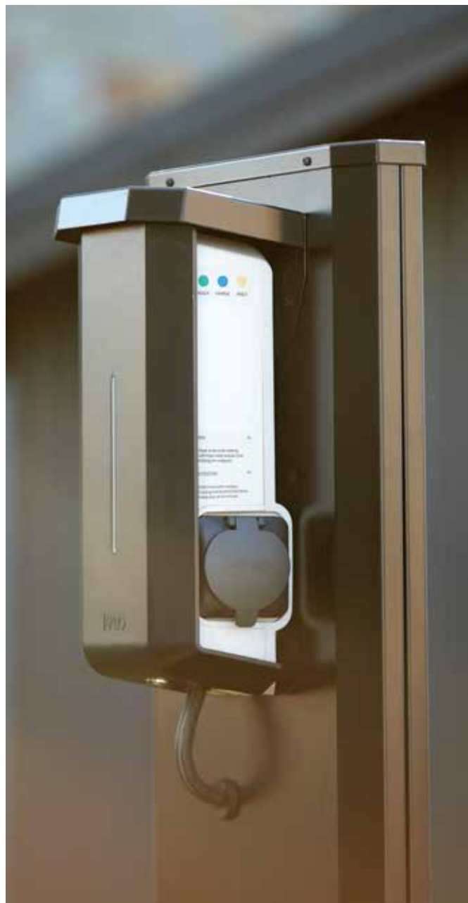
I Hammar, Kristianstad, har fastigheterna miljöcertificerats. Här har också Brinova investerat i solcellsanläggningar i området som tillför cirka 28 000 kWh per år och laddstolpar för laddning av elbilar.
